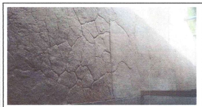
Foto 3: SE OBSERVA EL PIZO CON GRIETAS, SE NECESITA SUSTITUIRLO
